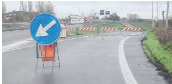
SVINCOLO TRA LE TANGENZIALI Il sottopasso ferroviario è chiuso da tre giorni.
