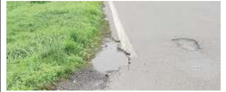
PERICOLO La strada corre lungo il canale Naviglio Taro.
